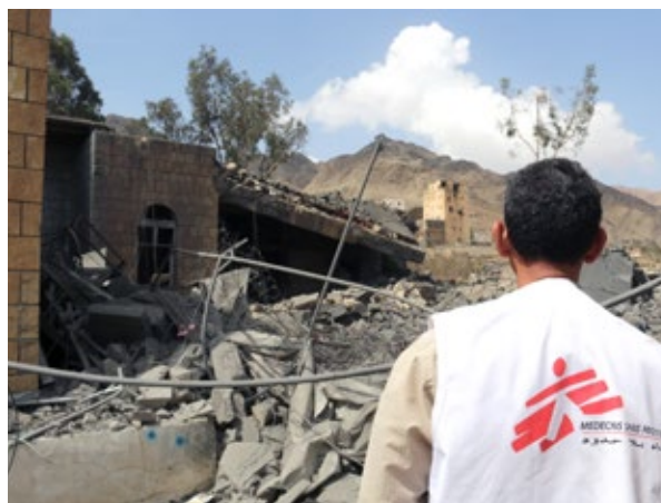
Jemen: Ein Mitarbeiter vor den Resten des zerstörten Krankenhauses in Haydan.
